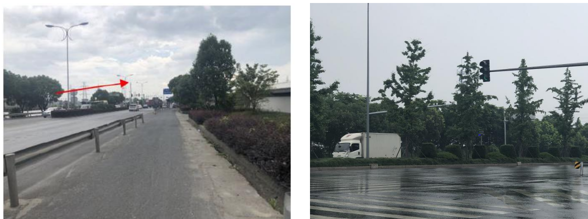
图 2.2-4 钱陶公路防护工程、排水工程现状照片
